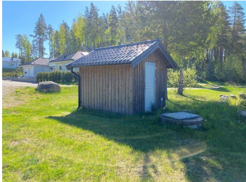
Bild 17 Pumpstationen som är centralt placerad i området.
